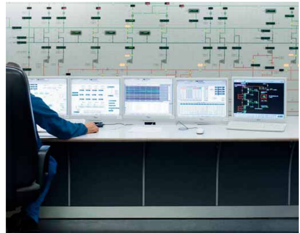
Die Wärmewarte im Kraftwerk – hier laufen sämtliche Informationen zusammen.
