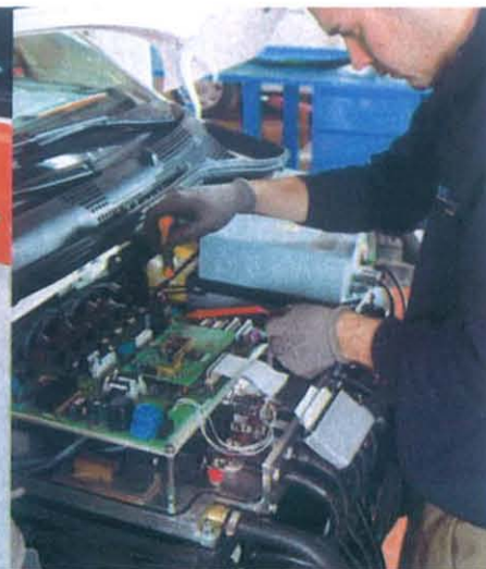
Die Leistungselektronik sitzt direkt über den kostbaren Batterien und dem E-Motor
